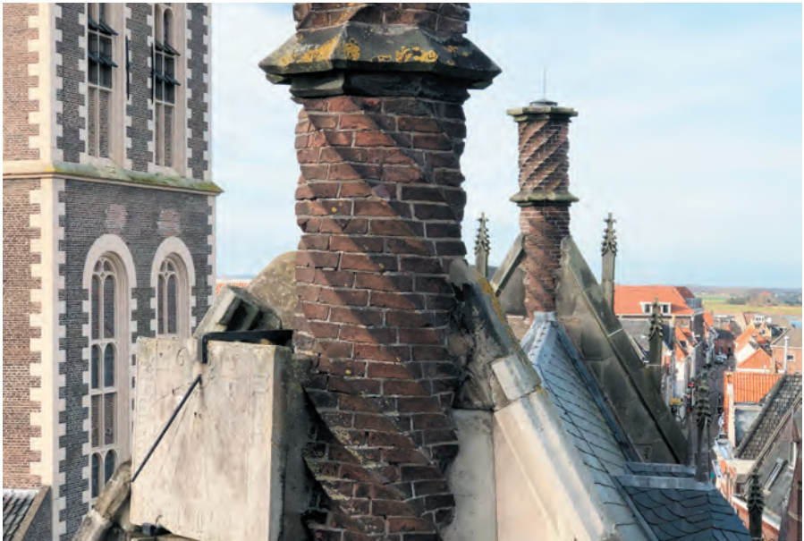
Zicht op de zuidgevel van de Schepenzaal van het Oude Raadhuis met zonnewijzer en getordeerde schoorstenen. Links is de Nieuwe Toren zichtbaar. De foto is genomen vanaf het Oude Wijnhuis. Foto Henk de Bruin.
