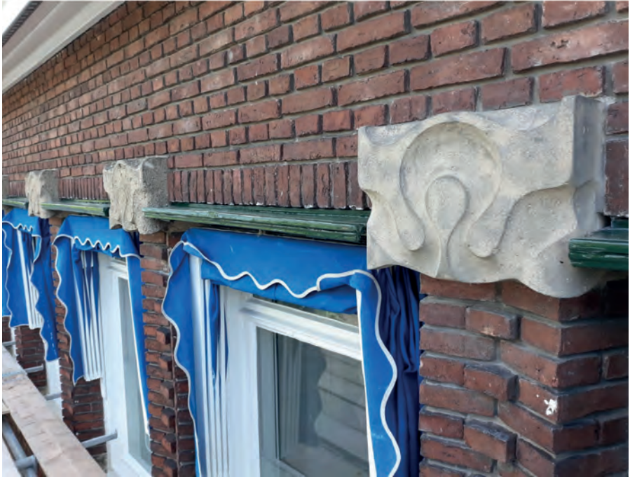
De gerestaureerde zandstenen ornamenten aan de voorgevel. Foto: collectie SNS Historisch Centrum.
