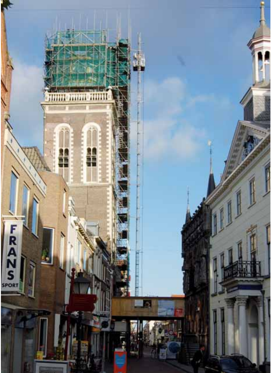
De demontage van de lantaarn tot aan de omloop is in december 2009 gereed. Foto H. van der Werf, Gemeente Kampen.
