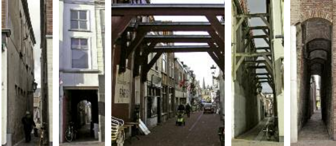
Vele stegen kruisen de hoofdstraat. De fundering van de huizen is slecht en daarom steunen de huizen elkaar met balken en gemetselde bogen.
