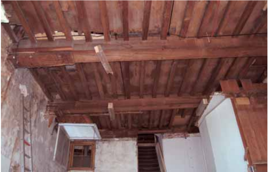
Blank eikenhouten zolderbalklaag met moer- en kinderbinten in het achterhuis. Het spreidseel tussen de kinderbinten voorkomt het doorsijpelen van zolderstof. De voorste moerbalk heeft een bij latere herstelwerkzaamheden aangebracht sleutelstuk en versterkende houten zijplaten. De originele peerkraalconsole bij de andere moerbalk is deels weggezaagd bij het aanbrengen van een (nu verwijderd) plafond. Foto H. van der Werf, gemeente Kampen.
